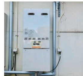
▲小型給湯器の導入(秦野工場)
