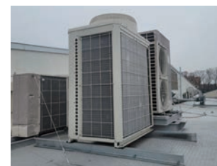
▲埼玉工場チラー設備の室外機
