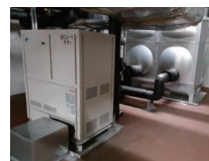
▲ホームパイブラインチラーユニット&タンク
