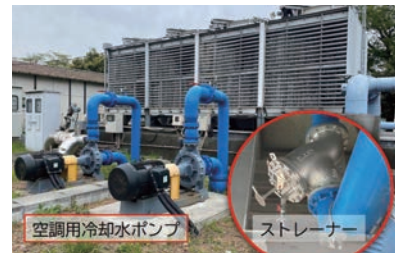
▲秦野工場 空調用冷却水ポンプと冷却水配管のストレナー
