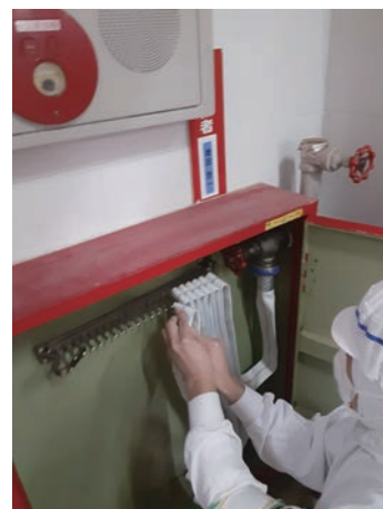
▲消火栓のホースの点検
